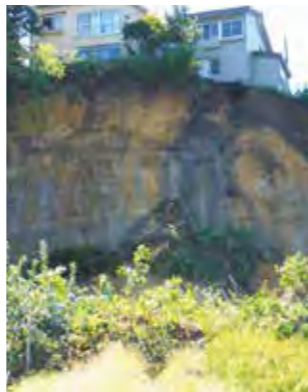
西茂森地区:がけ崩れが発生し、住民に避難指示が出された 写真提供:弘前市
